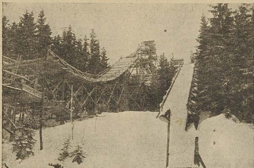
Nový velký můstek ve Sv. Petru těsně před dokončením. Tesaři v této chvíli ještě dohotovovali hořejší konec nájezdu. Celý nájezd i hořejší část bubnu je dřevěná konstrukce
